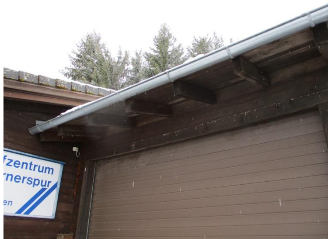
Kotspuren unter Dachbalken des Langlaufzentrums
